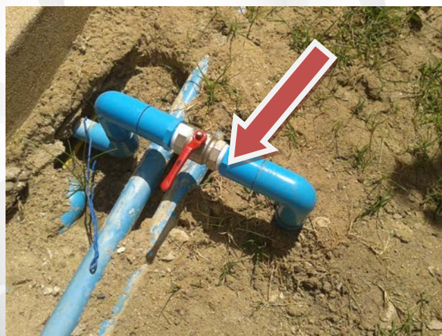
วาล์วควบคุมน้ำแท็งค์บาดาลอยู่ข้างแท็งค์บาดาล (ข้างหอนาฬิกา)
