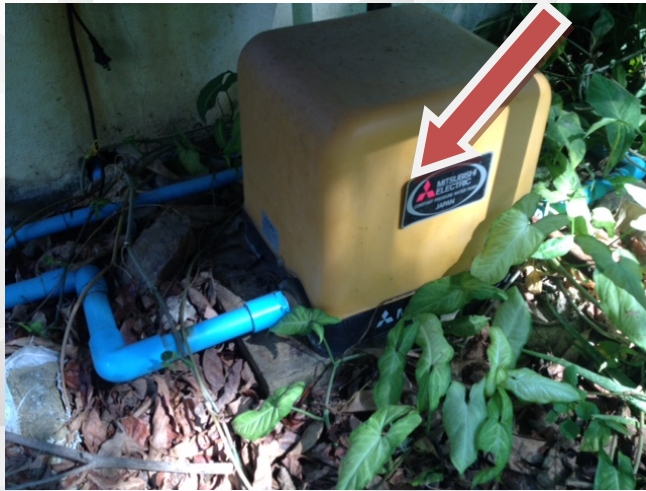
P7 บั้มสูบน้ำเรือนเพาะชำ ติดตั้งอยู่บริเวณด้านหลังของเรือนเพาะชำ
